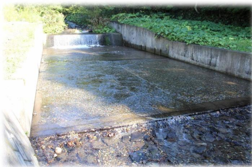
気仙川表流水取水施設
