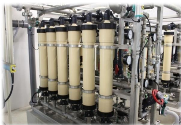
北湯沢浄水場膜ろ過装置
