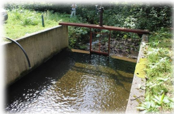
本町川表流水取水施設
