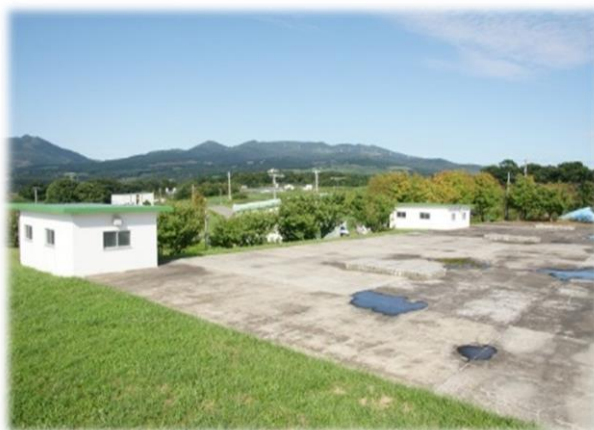
北黄金浄水場緩速ろ過池
