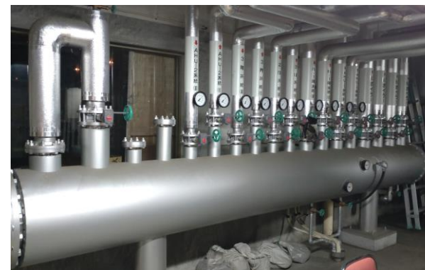
ボイラー室（地階）
