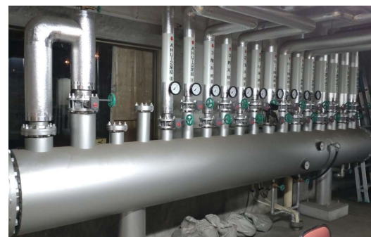
ボイラー室（地階）
