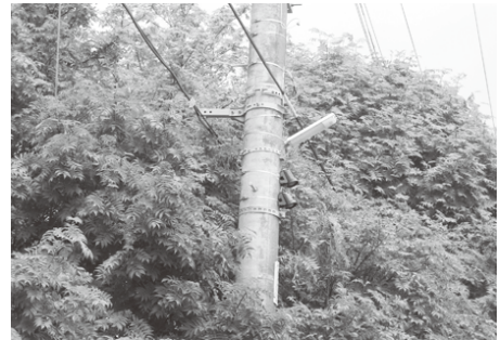
樹木の枝葉に埋もれ込む防犯灯
